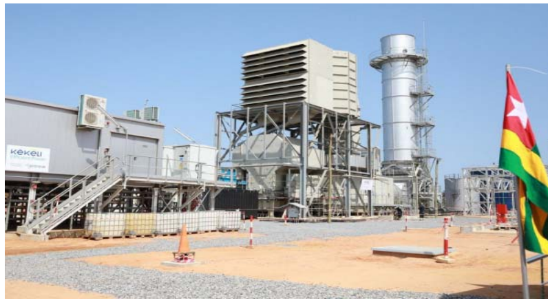
La centrale électrique Kékéli
