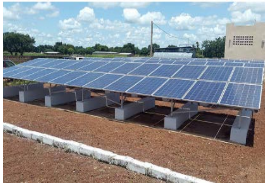
Des panneaux solaires
