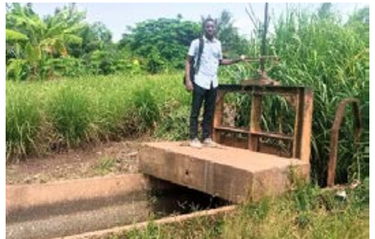
Un jeune identifie un ouvrage vétuste
