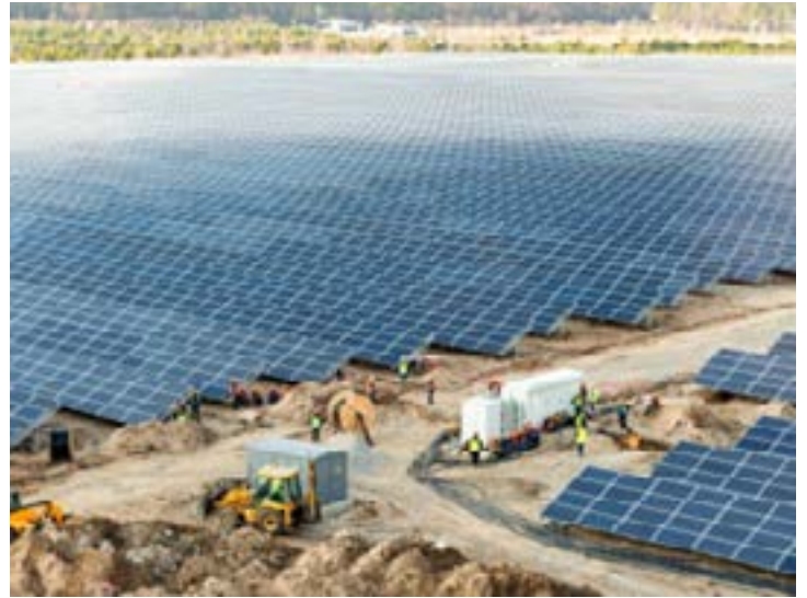
Des plaques solaires
