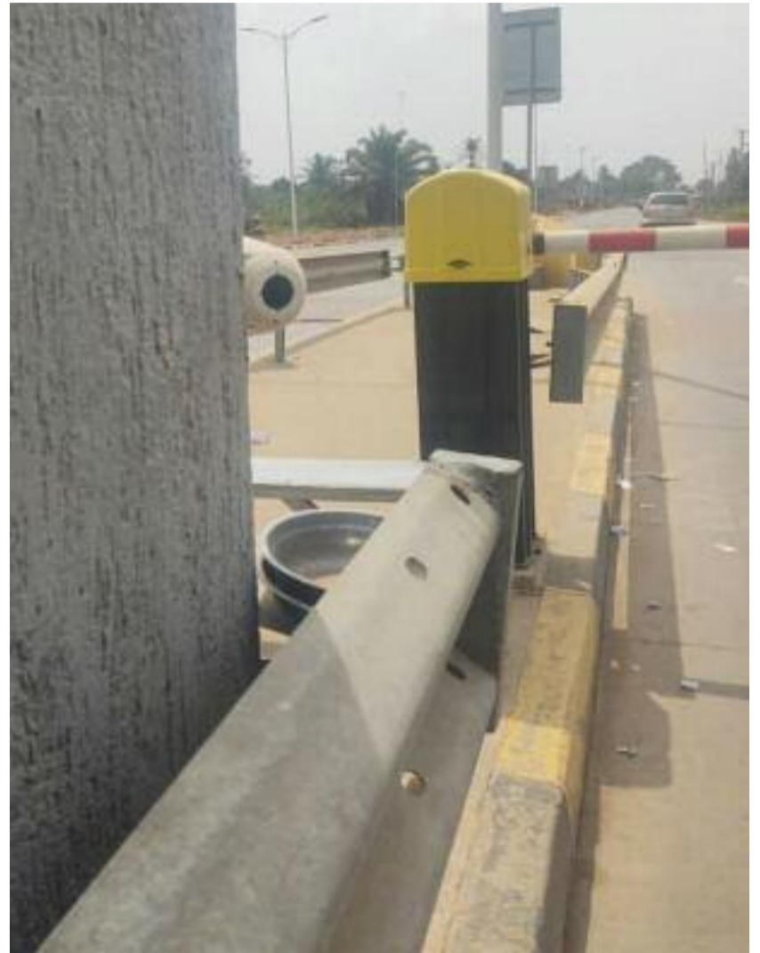
Poste de péage équipé du système de vidéo surveillance
