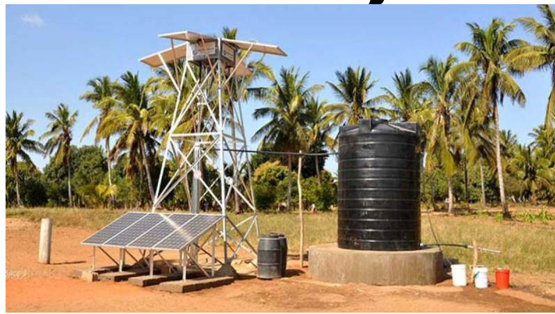
Un système d'approvisionnement en eau potable
