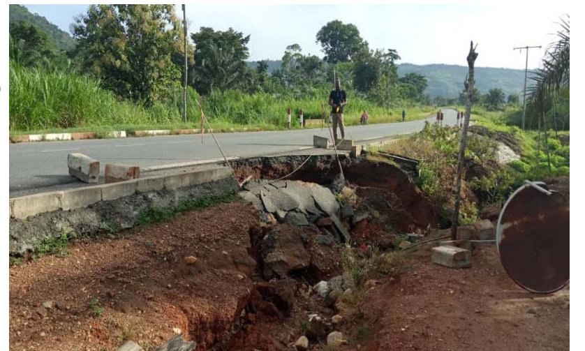
Une route en mauvais état
