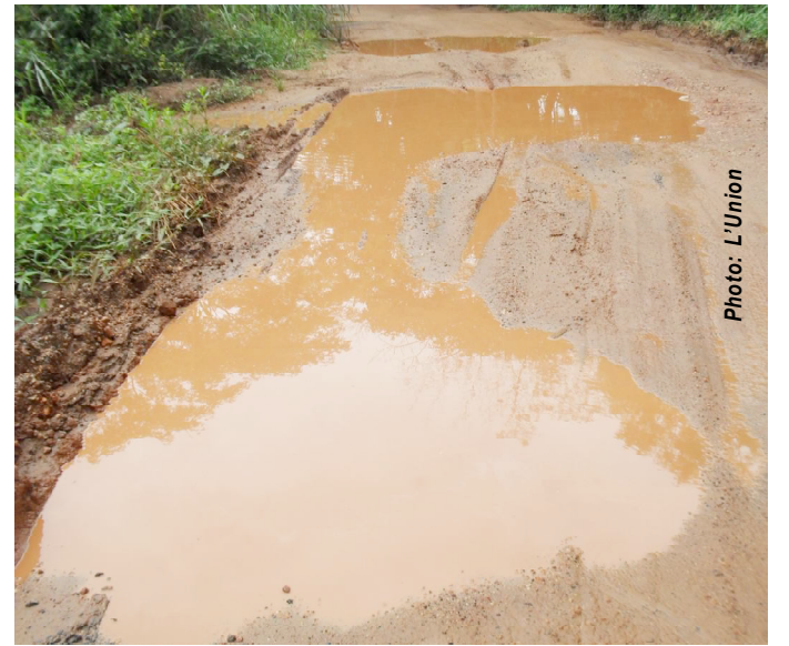
L'un des tronçons fortement dégradé par les eaux de pluies
