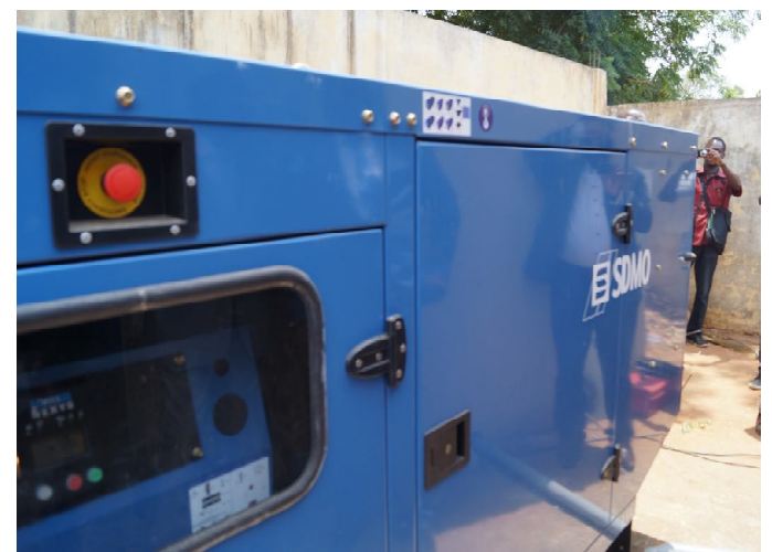
Le groupe électrogène de 110 KVA
