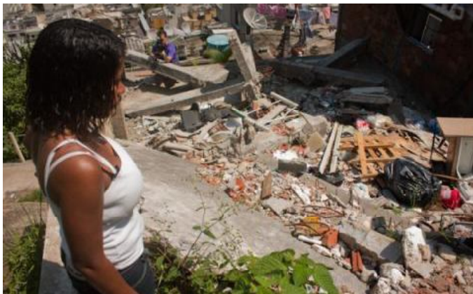
Une Togolaise devant les ruines d'une démolition
