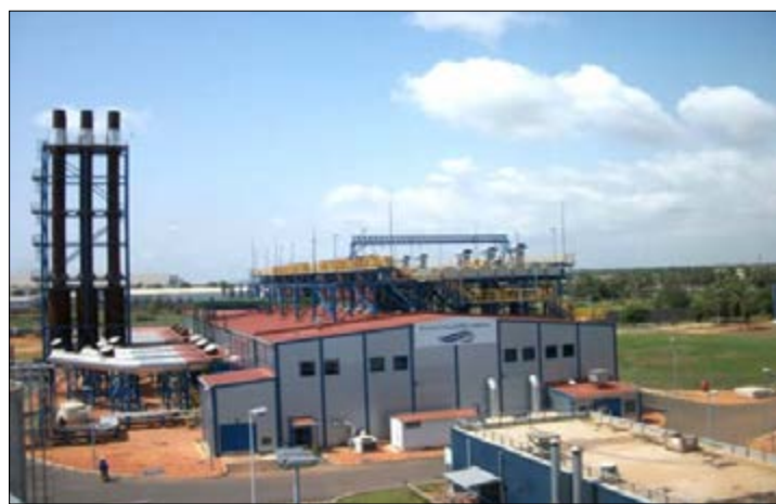
La centrale thermique de Lomé
