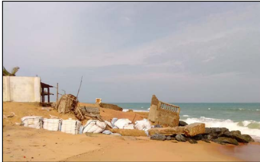
Une partie de l'hôtel résidence madiba ravagée malgré quelques travaux de protection du site
