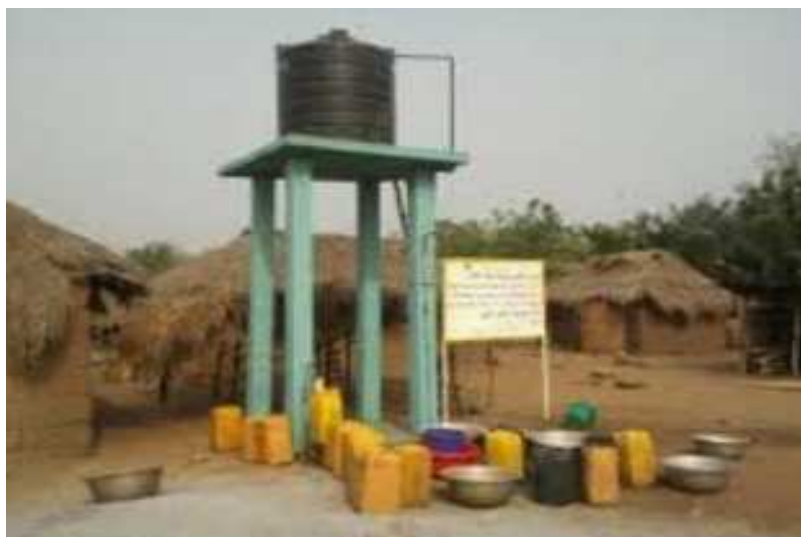
Un forage d'eau
